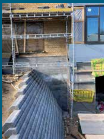
Byggeplads i Gilleleje Bavn Ager, hvor John Jensen arbejder. Oprydning mangler generelt, ophæng af ledninger, afskærmning ved kant af stensætning, der er langt at falde og ikke et hensigtsmæssigt underlag at lande på. Man kan se der har været problemer med stilladset, det vrider da der ikke var plads til den valgte løsning. Pladsen har været besøgt flere gange og Arbejdstilsynet er inde over.
