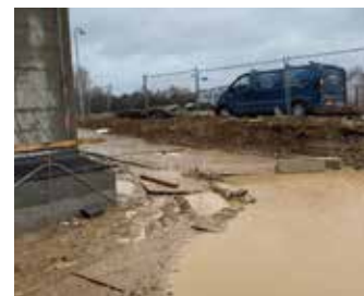
Byggeplads i Gilleleje Bavn Ager, hvor John Jensen arbejder. Der er gjort for lidt for at modstå den meget regn vi har fået i marts, det kniber med oprydning og ophængning af ledninger.
