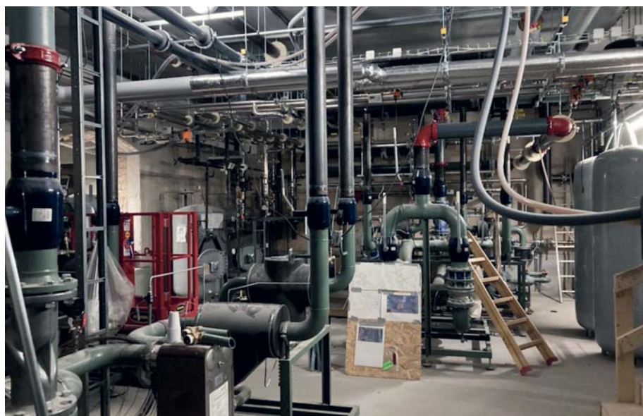
Dybt under museet er installeret et omfattende varme- og køleanlæg.
